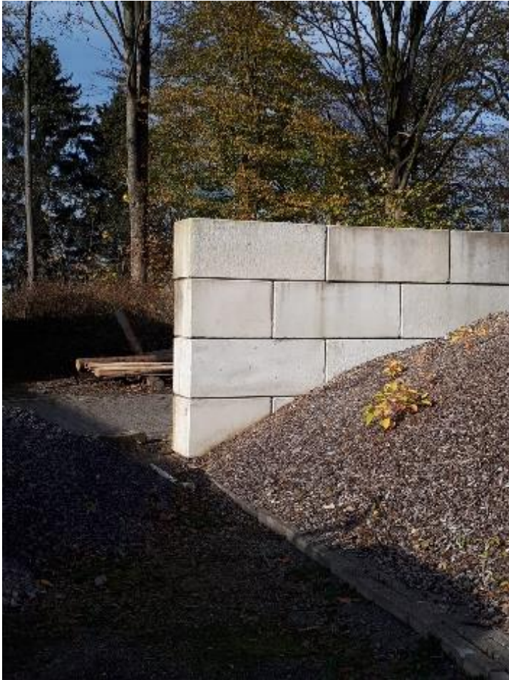
Das Trocknungslager befindet sich auf dem städtischen Betriebshof „Sonne“ und wird mit Holzhackschnitzeln der FBG befüllt
