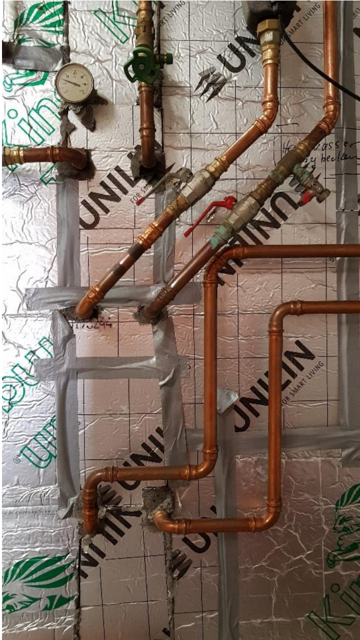
Die Wasserbatterie erhitzt mehrere Sekundarkreisläufe.
