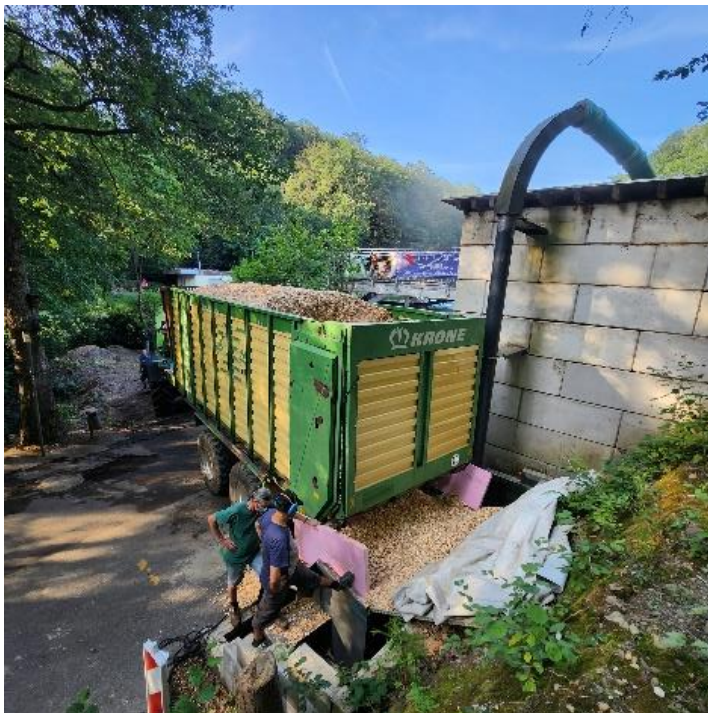
... und in eine automatische Befüllanlage geschüttet und in den Brennstoffbunker einblasen
